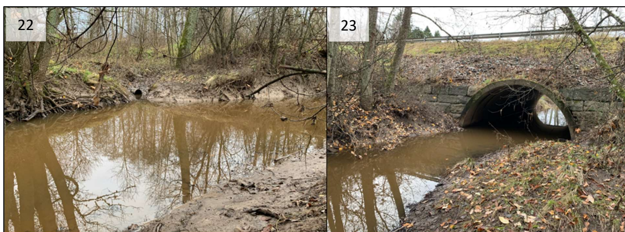
Figur 3-11 – (22) Exponerade rötter och utlopp från rör utmed östra strandkanten. (23) Södergatan som korsar Mjölån.
