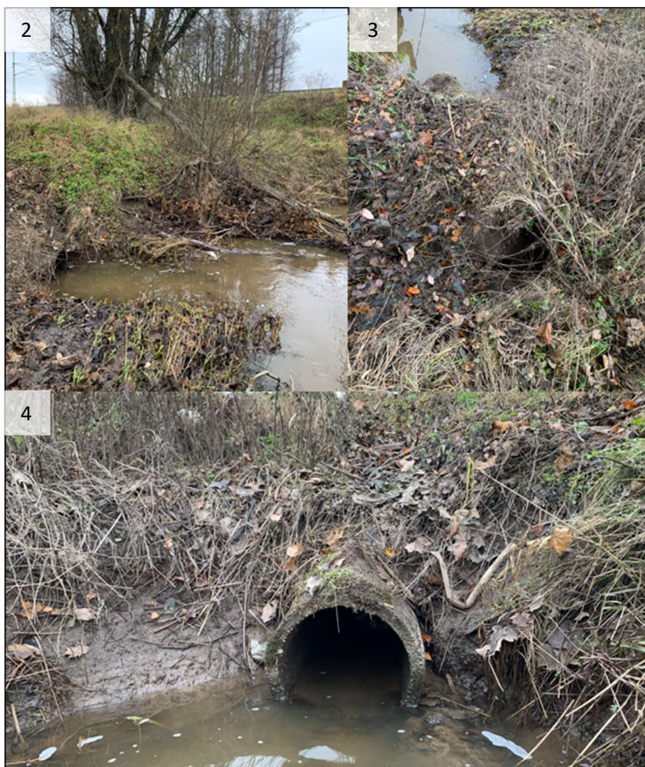
Figur 3-3 – (2) Utlopp från betongröret, bild tagen i nordvästlig riktning. (3) Pågående lokalt skred med sprickbildning. (4) Utlopp från betongröret.
